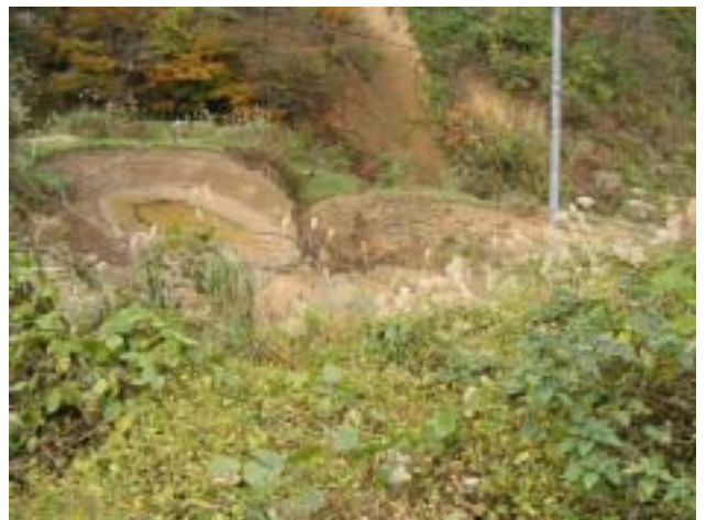
養鯉池もいたる所で崩壊
