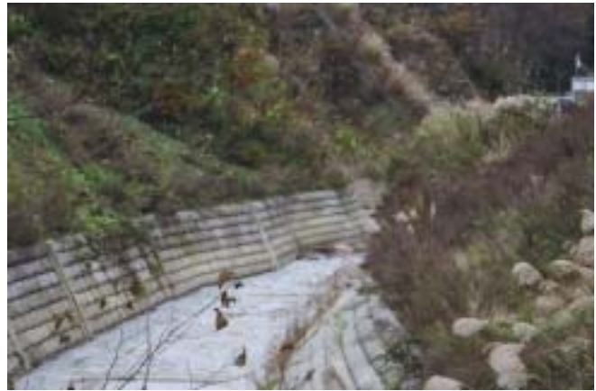
護岸は地震の影響で隙間ができ、曲がっている
