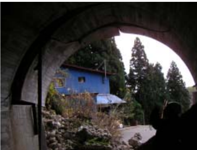
木沢隧道は崩落が激しく、割れた隙間から青空が見え、この地域の地震の強さを表している
