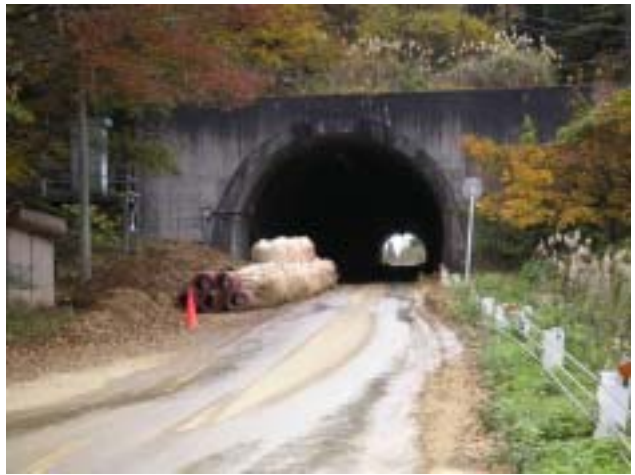
荒谷トンネルを越えて地点で、周辺の崩落は激しい
