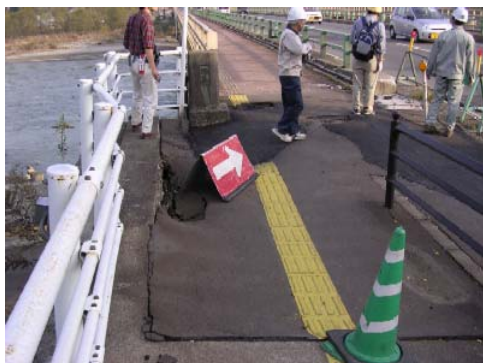
写真-29 橋台背面の地盤沈下
