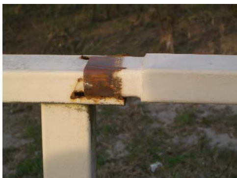
写真-31 高欄手すり継ぎ目部の横ずれ
