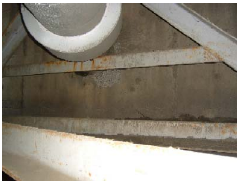
写真-1 桁下配管部のコンクリートの破損など，全体的には損傷少ない。
