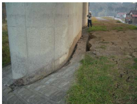
写真-15 橋脚周辺の地盤沈下（約 300mm）
