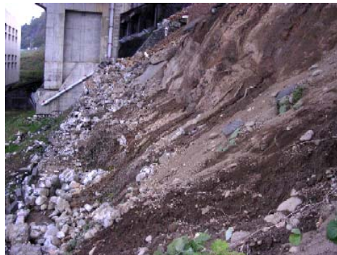
写真-34 法面の崩壊
