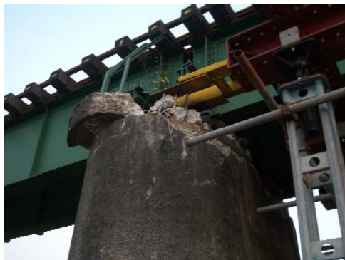
写真-16 支承部およびそのコンクリート橋脚の崩壊
