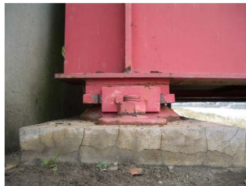
写真-54 桁移動にともなう支承部の変形
