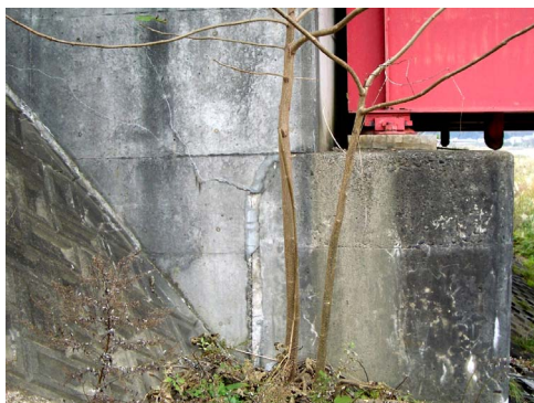
写真-53 橋台コンクリートひびわれ その他，橋台背面の地盤沈下による段差
