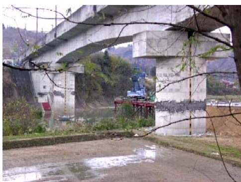
写真-47 橋脚柱中間部の破壊
