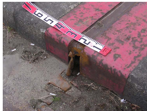
写真-52 歩道部の中間エキスパンションの抜けと戻し（約70mm）
