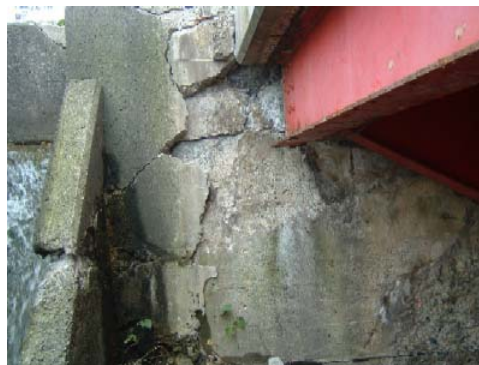
写真-46 橋台の壁面の破損
