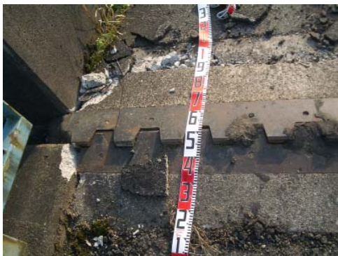
写真-10 エキスパンションジョイント部の段差
