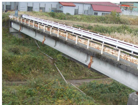
写真-58 添架物（配管）の落下
