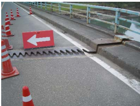
写真-35 エキスパンションジョイント部の段差（最大約 80mm）
