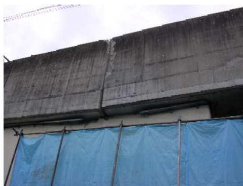
写真-50 壁高欄の破損
