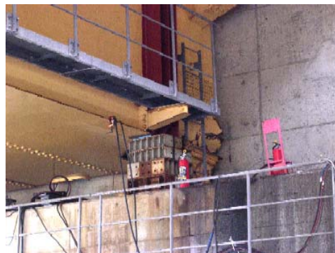
写真-38 腹板のき裂変形と補修状況
