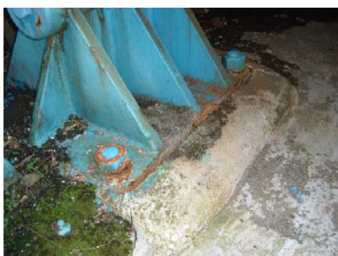
写真-8 支承アンカーボルトの緩み・ コンクリート底版の亀裂
