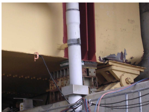
写真-37 端支承部の箱桁下フランジの大規模き裂と補修状況
