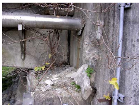
写真-42 橋台(側面)コンクリートの破損
