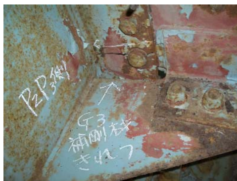
写真-19 垂直補剛材のボルト孔からのき裂（端対傾構ガセット位置）
