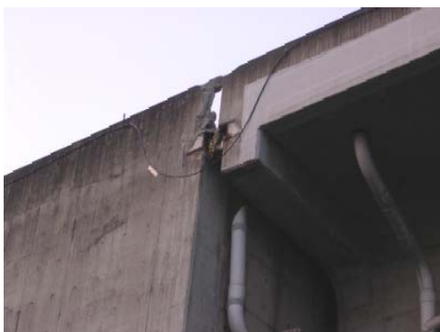
写真-14 壁高欄の破損
