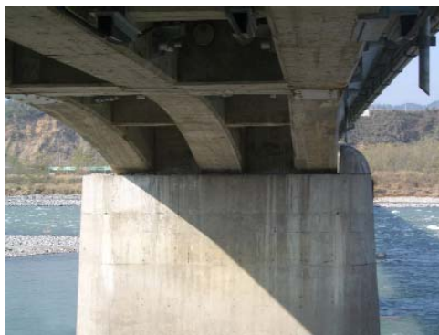
写真-2 上流側（左）のドーム型化粧コンクリートブロックの落下
