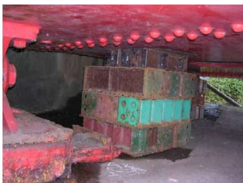
写真-55 支承部の破損と仮受け状況 その他，RC橋脚のひび割れ，橋台背面の地盤沈下による段差，など
