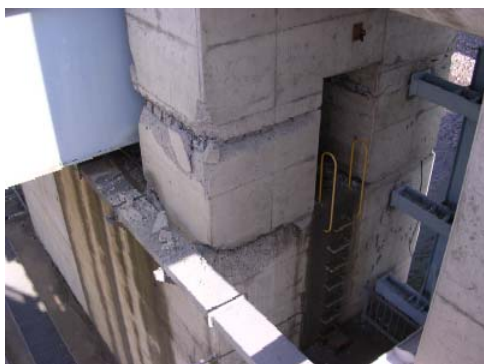
写真-20 第1ゲートのRC柱の破壊
