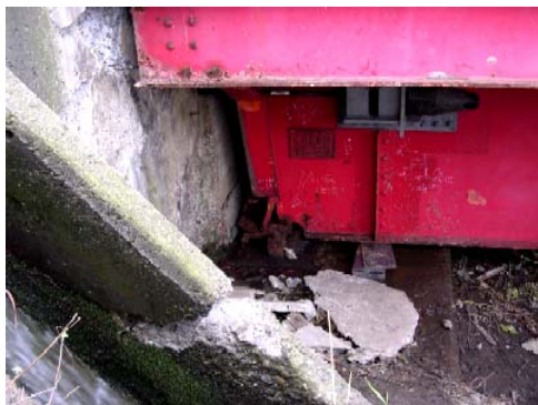
写真-45 桁端支承部の破損 その他、橋台背面の地盤沈下による段差，など
