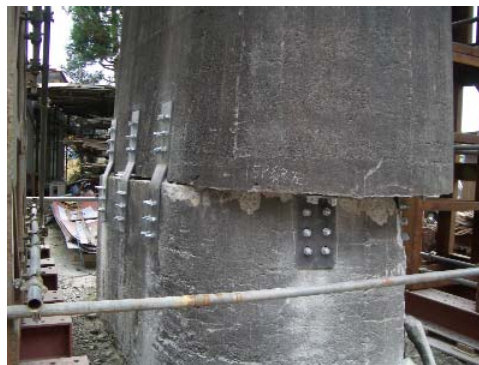
写真-40 コンクリート橋脚基部の損傷
