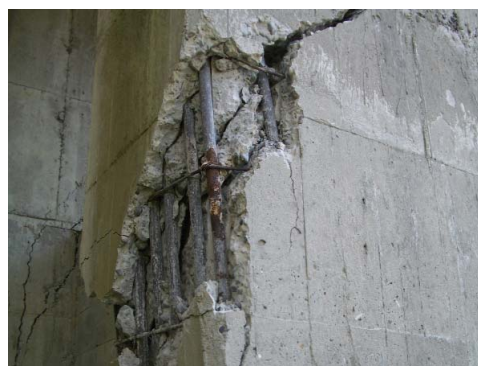
写真-27 せん断破壊(拡大，丸鋼鉄筋)
