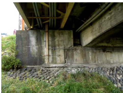
写真-41 橋台コンクリートのひび割れ
