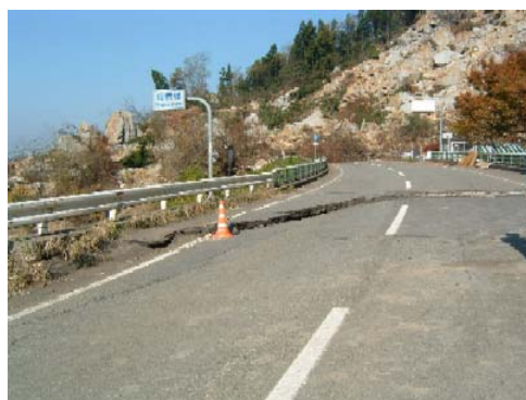
写真-24 橋台との境界部の陥没
