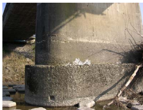
写真-5 橋脚基部のコンクリートの破損
