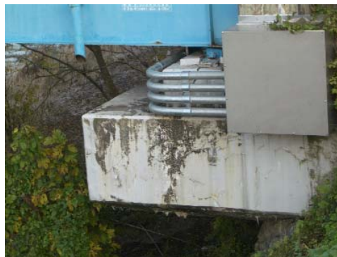
写真-11 支承コンクリート部の破壊
