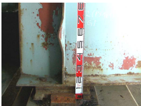
写真-18 支点部鉛直補剛材の座屈変形（端対傾構ガセット位置）
