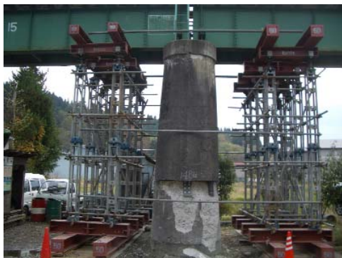
写真-39 橋脚基部の損傷と応急補強 その他，支承部のずれ変形，JR 飯山線不通，など
