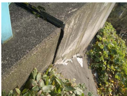
写真-6 橋台と法面の境界部のずれによる 吹き付けコンクリートの破損
