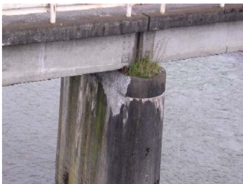
写真-57 中間橋脚上面のコンクリートの破損 その他，支承部の割れ，通行止め，など
