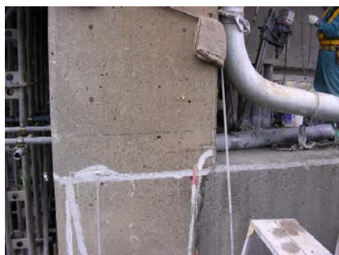
写真-43 橋台のコンクリート亀裂補修 その他，橋台周辺の地盤沈下（約 400mm），
