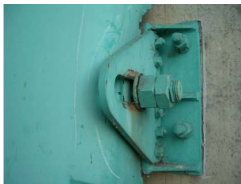
写真-13 落橋防止構造のずれ（約 100mm）とウェブの変形
