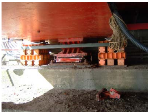
写真-22 支承部の崩壊と仮受け状況
