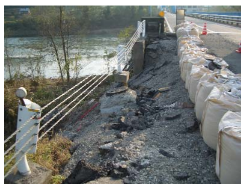
写真-9 橋台背面の地盤崩壊
