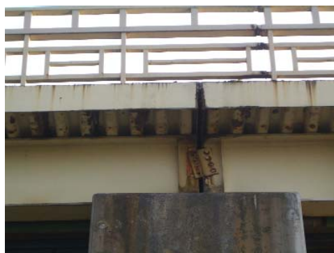
写真-32 腹板接合部ボルトの落下
