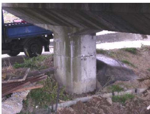
写真-49 ラーメン橋脚のせん断ひび割れ その他、法面の崩壊，ラーメン橋脚の沈下，など
