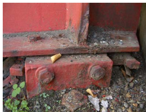
写真-25 桁移動による支承部の変形
