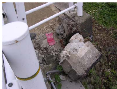
写真-56 橋詰めのコンクリートの損傷
