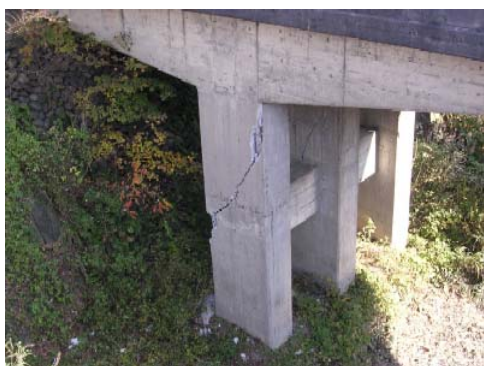
写真-26 橋脚のせん断破壊
