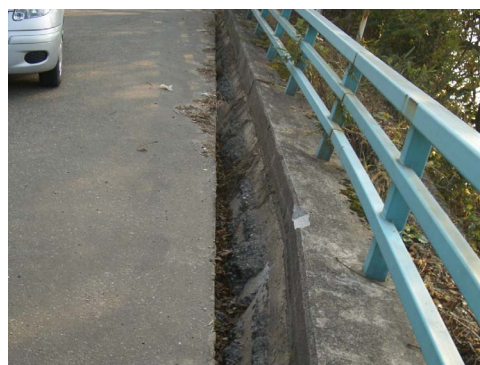
写真-7 アプローチ部の護岸の崩壊
