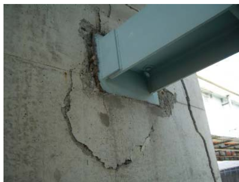
写真-21 RC柱の横梁取り付け部の破壊
