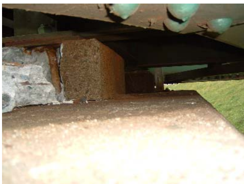
写真-59 支承部コンクリートの破断と アンカーボルトの変形
