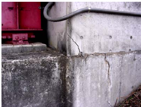
写真-51 橋台コンクリートひびわれ
