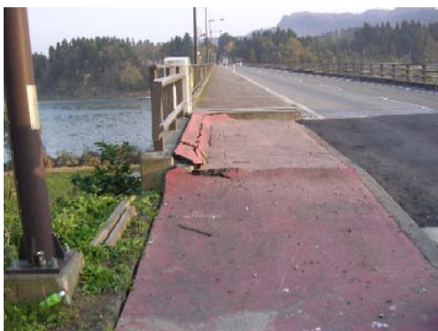
写真-12 橋台背面の地盤沈下による段差
