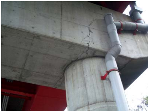
写真-33 RC 橋脚はり部のクラック
